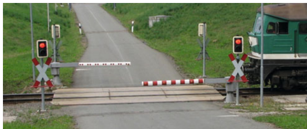
Abb. 8.4 Bahnübergang mit Lichtzeichen und Halbschranken
