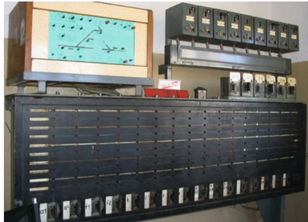
Abb. 6.8 Schlüsselwerk ( unten ) mit Weiterverarbeitung der Fahrstraßenschlüssel in Schlüsselsperren ( oben rechts )
