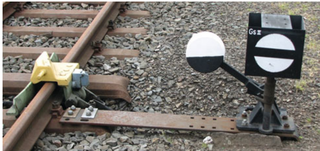
Abb. 4.45 Mechanisch ortsbetiente Gleissperre
