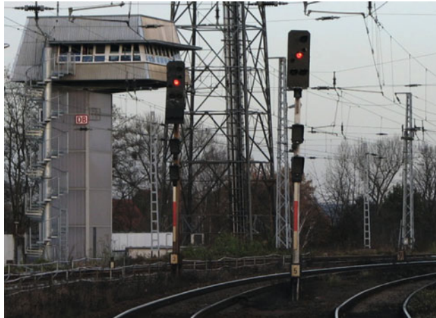
Abb. 4.60 Lichtsignale des HI-Systems mit Stellwerks-hochbau im Hintergrund
