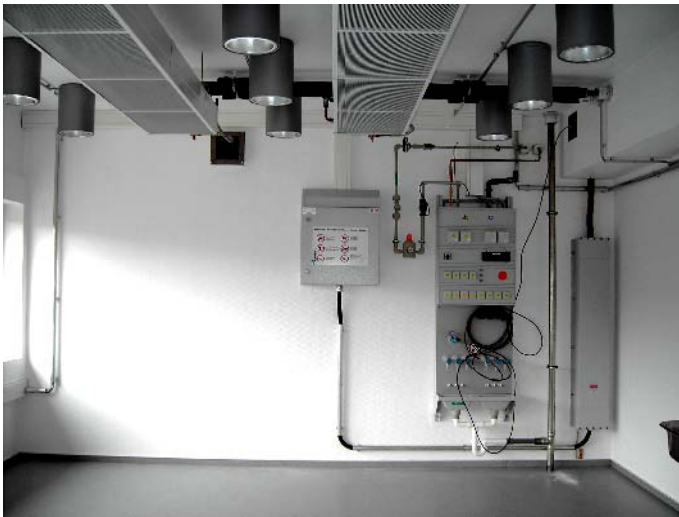
Bild 4.56 Geschirmter Laborraum, Foto: emscreen GmbH.
